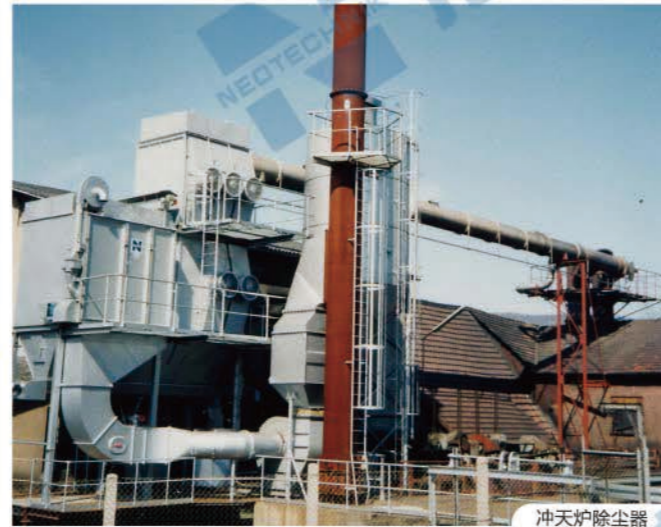
冲天炉除尘器
