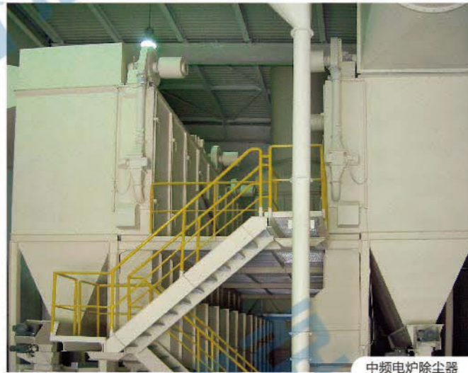
中频电炉除尘器
