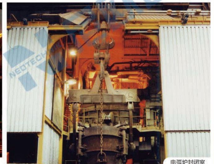
电弧炉封闭室
